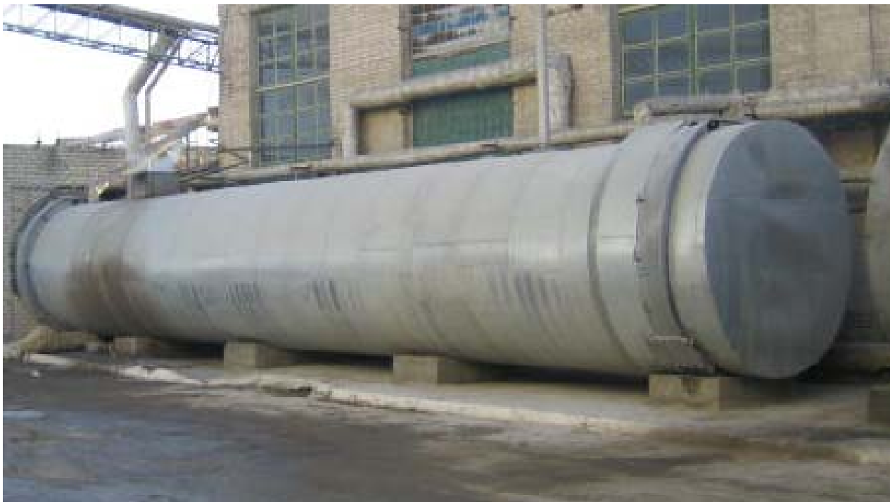
Малюнак 2. Знешні выгляд эксплуатаванай цеплаўтылізацыйнай устаноўкі
