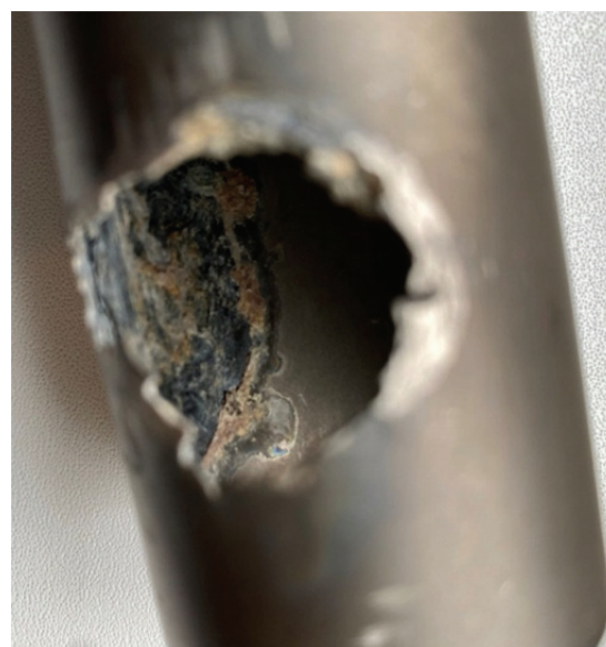
Рис. 1. Коррозия титановой трубки
